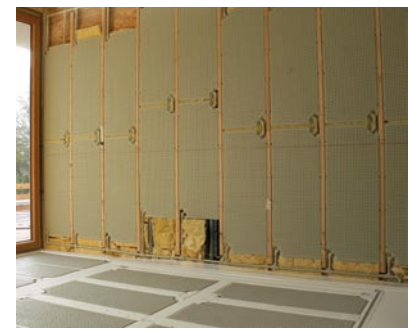
Die Kombination von Fußboden- und Wandflächen ist mit den Modul-Klimatelementen in einer einheitlichen Technologie und als Komplettlösung ausführbar.
